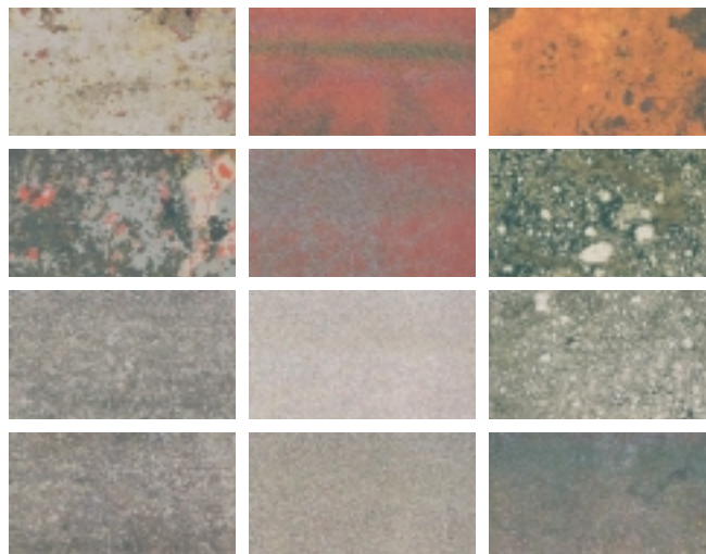
Old paint Red epoxy shop primer Rust
